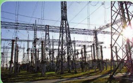
محطة توليد كهرباء شمال القاهرة
